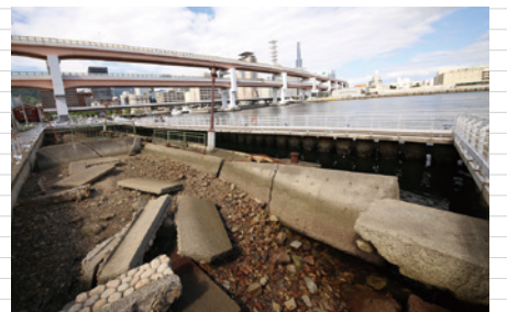
阪神・淡路大震災で被災したメリケン波止場の崩れた岸壁
