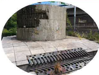
★ 被災した浜手バイパスの橋脚
